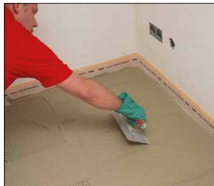
11 Aufziehen der Kontaktschicht und des Kammbetts. Für den noch schnelleren Baufortschritt empfehlen wir Sopro VarioFlex® HF®.
