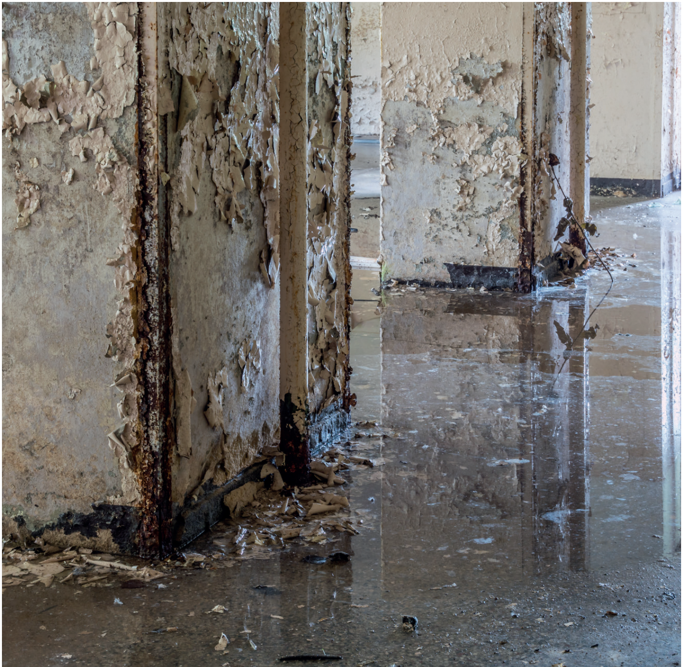
Geschädigte Bausubstanz eines Gebäudes nach einem Hochwasser.
